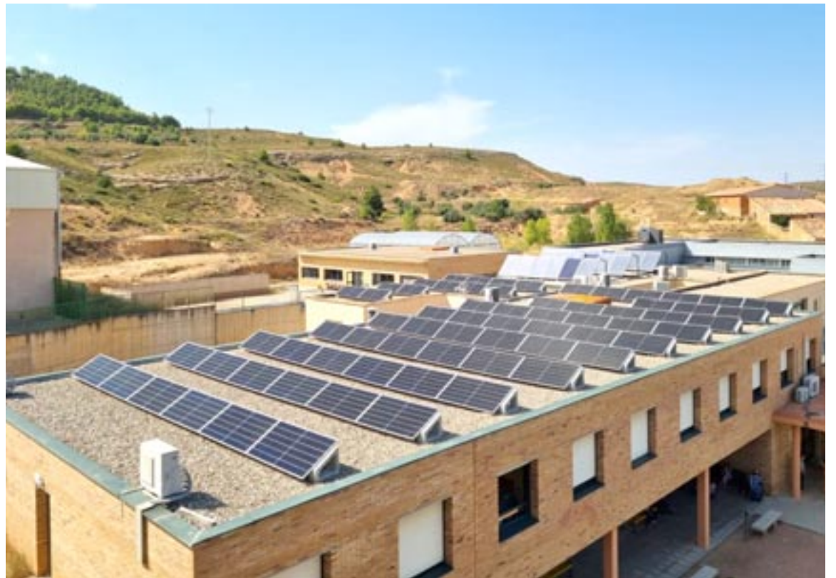
Placas solares instaladas en la azotea de Atadi Alcorisa
